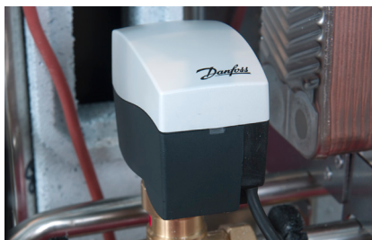
17A. Motorventil til regulering af fremløbstemperaturen til radiatoranlægget.
