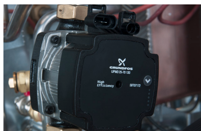
29. Pumpe til cirkulation af vandet i radiatoranlægget.
