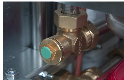
16. Snavssamler/snavsfilter til opsamling af snavs i rørledningerne (grøn markering).
