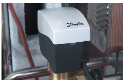
17A. Motorventil til regulering af fremløbstemperaturen til radiatoranlægget.
