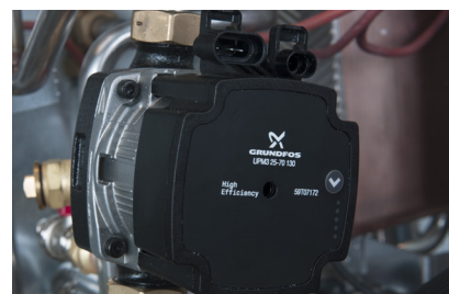
29. Pumpe til cirkulation af vandet i radiatoranlægget.
